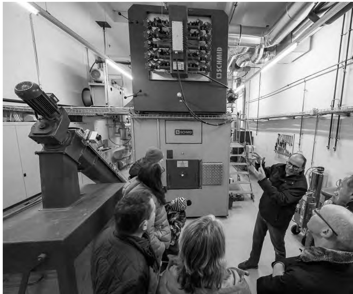
Florian Oetterli erklärt Details zum Heizkessel.
