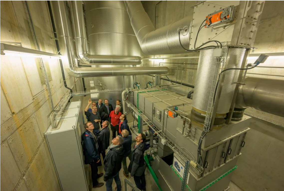
Der Raum mit den Wärmespeichern und der Rauchgasreinigung
