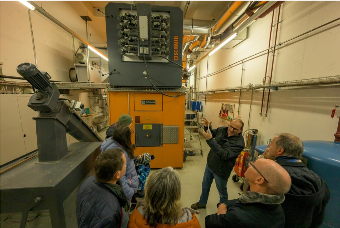
Florian Oetterli erklärt Details zum Heizkessel
